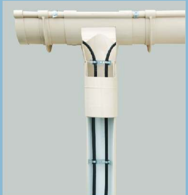
Mocowanie przewodów grzejnych w rurze spustowej przy pomocy taśmy montażowej ELEKTRA TMS
